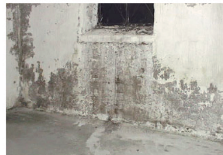
Bild 2.5: Feuchtigkeit im Souterrain - Bestand [15]
